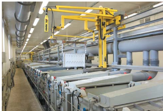
Гальванический участок (г. Мытищи)
